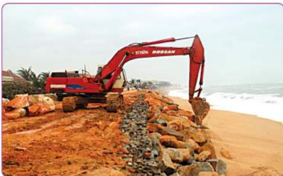
Hình 2.5. Sạt lở kè Xóm Rờ, phường Phú Đông, thành phố Tuy Hoà (Ảnh: Văn Tài)
