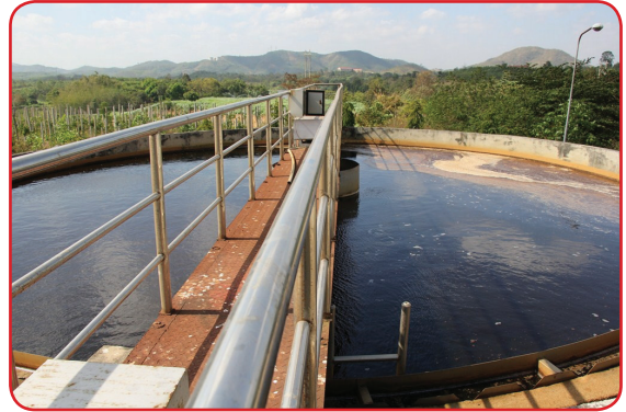
Hình 7.8. Hệ thống xử lý nước thải tập trung tại khu công nghiệp Hoà Phú
